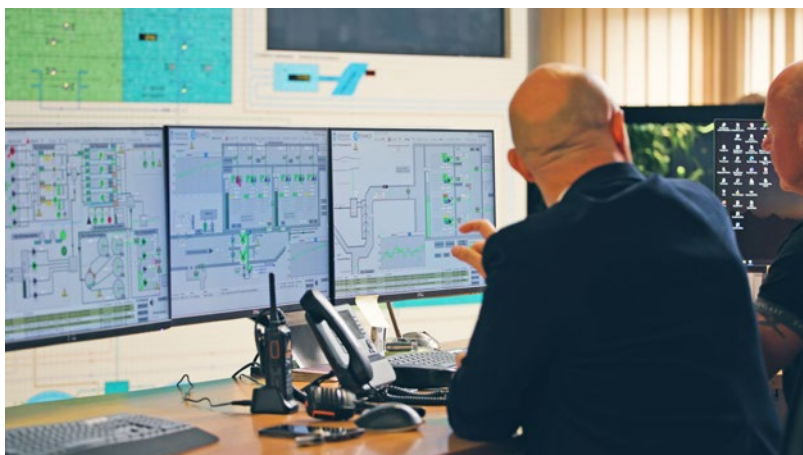
☛ Centrum sterowania Zakładu Oczyszczania Ścieków Płaszów. Źródło: ASTOR
