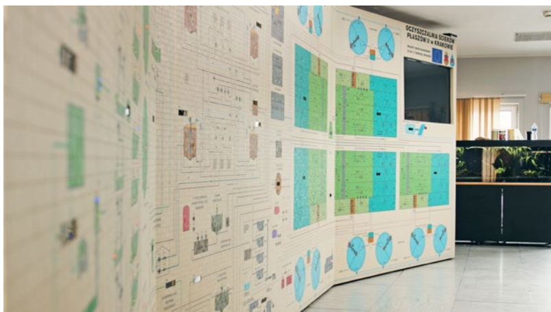
☛ Zakład Oczyszczania Ścieków Płaszów. Źródło: ASTOR
