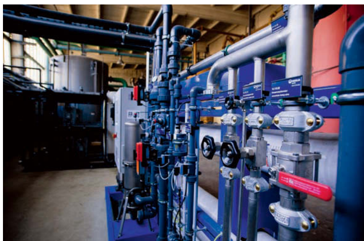
Fragmety instalacji technologicznych Elektrociepłowni Zgierz
