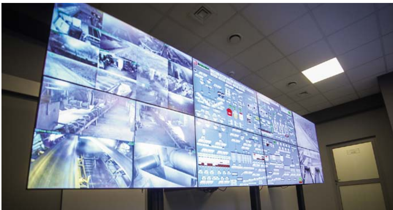
Centrum Zarządzania Ruchem ZPMW Centrum z wideościaną
