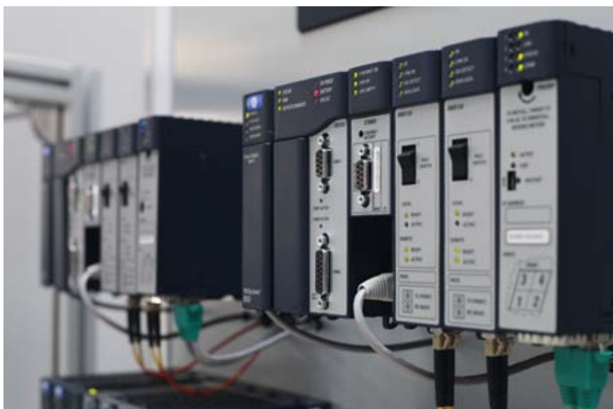
System wysokiej dostępności zbudowany na bazie sieci Profinet
