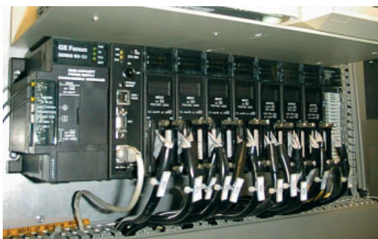
Rys.1. Widok sterownika układu wyprowadzenia mocy generatora w Elektrowni Skawina wyposażonego w moduły MDL655 połączone z separatorami SI, co umożliwia podłączenie 224 sygnałów wejściowych
