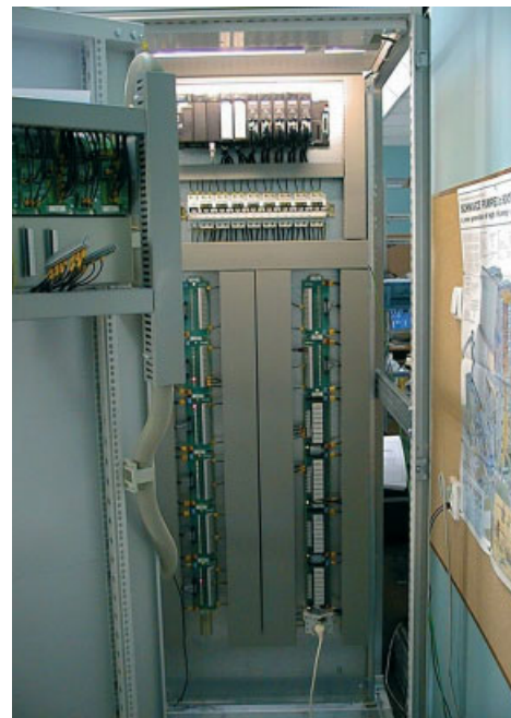
Rys. 2. Wnętrze szafy sterownika układu elektrycznego generatora nr 6 w Elektrowni Konin z zabudowanymi separatorami rodziny ET
