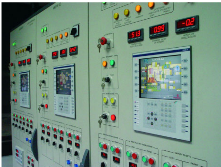
Rys. 1. Wygląd szaf sterowniczych z automatyką ciepłowni
