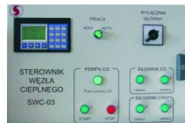
Rys. 2. Szafa sterownicza regulatora węzła cieplnego
