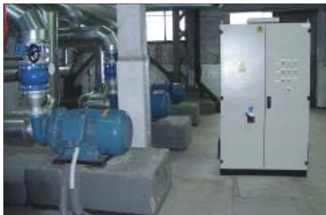
Rys. 2. Widok na szafę sterowniczą i pompy obiegowe.
