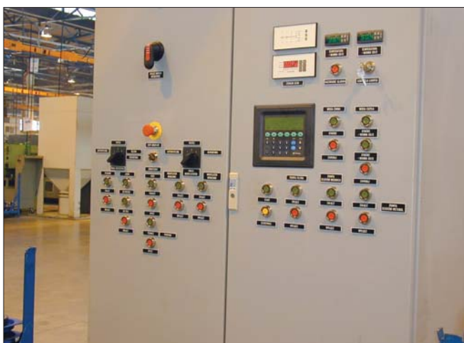
Pulpit obsługowy linii z panelem operatorskim Datapanel 150.
