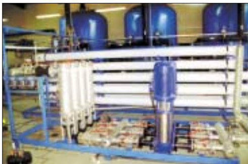
Rys. 4. Zasilanie odwróconej osmozy — pompy wysokociśnieniowe zasilające osmozę.
