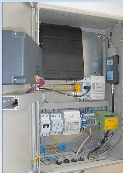
Szafka elektryczna w węźle grupowym SW 110 przy ul. Golezowskiej
